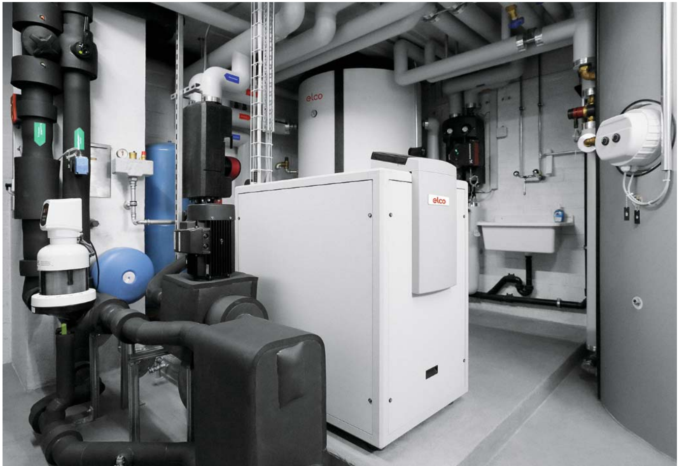
Blick in den Heizungskeller mit Grundwasserkreis und Zwischenkreis, (links), Wärmepumpe und Warmwasser- und Pufferspeicher.
