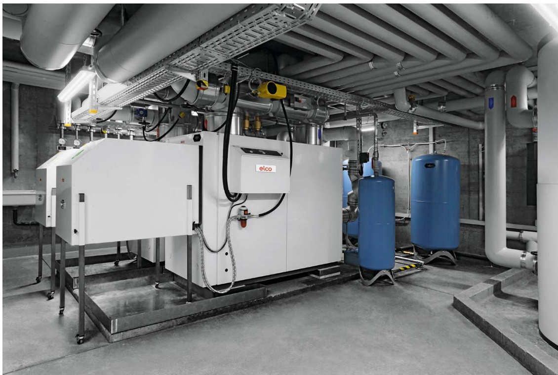
Scorcio della centrale termica con le due caldaie a gasolio a condensazione totale STRATON XL e uno dei due accumulatori tampone VISTRON B da 2000 litri.
