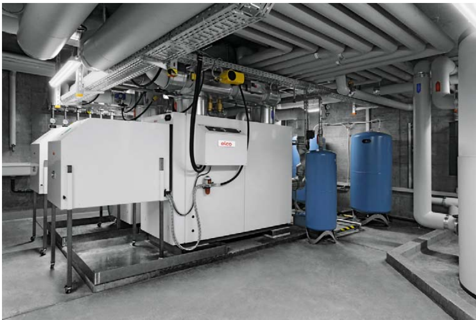
La centrale de chauffage avec les deux chaudières à mazout à condensation intégrale STRATON® XL et l'un des deux accumulateurs tampons VISTRON® B de 2'000 litres.
