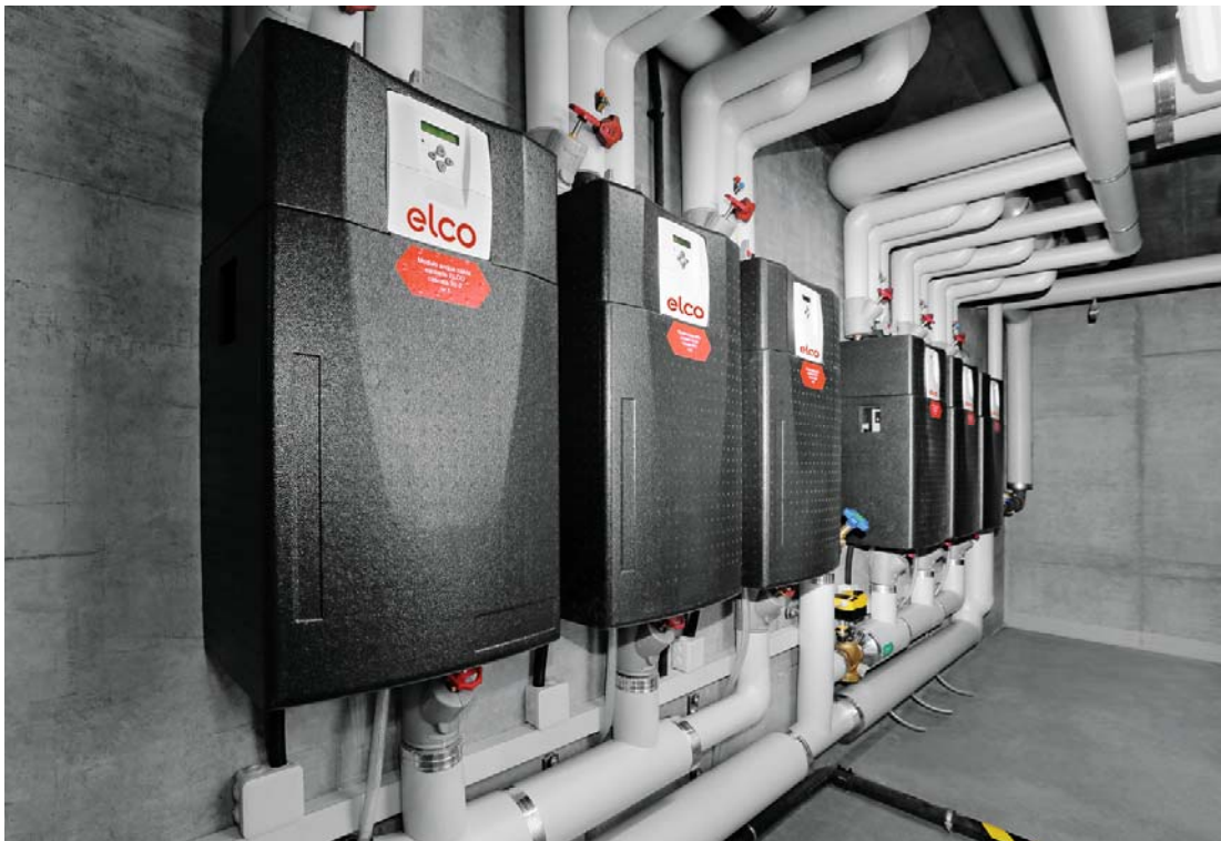
Six des huit modules pour eau chaude sanitaire type 50-2, à savoir deux cascades de trois unités chacune, ont été installés dans la centrale de chauffage.
