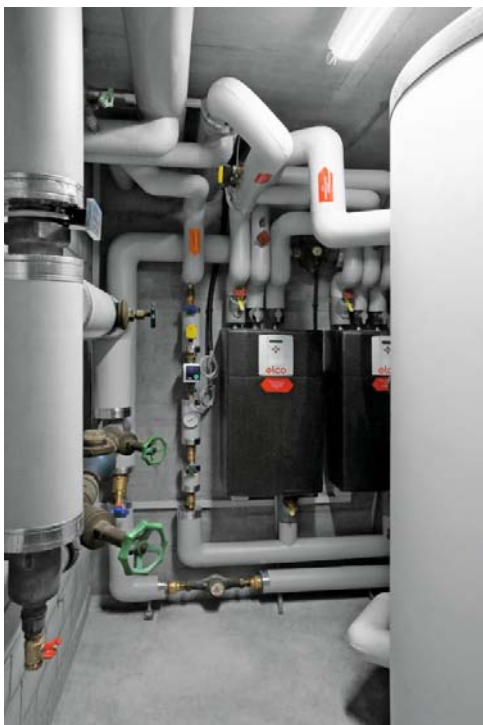
Deux modules pour eau chaude sanitaire en cascade et un accumulateur tampon VISTRON® B de 1'500 litres dans la sous-station.
