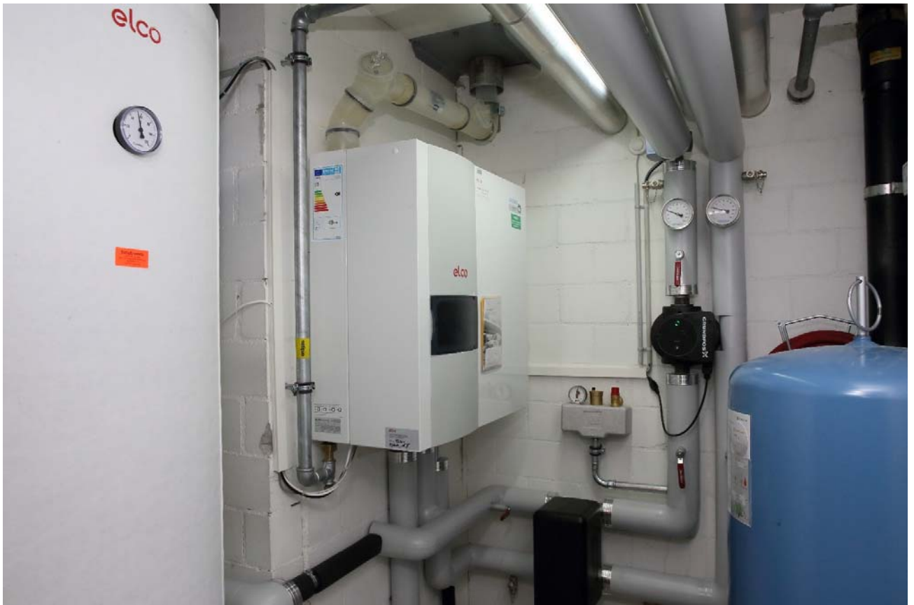
Vue sur la nouvelle installation de chauffage du locatif avec la chaudière THISION® S 50.2.
