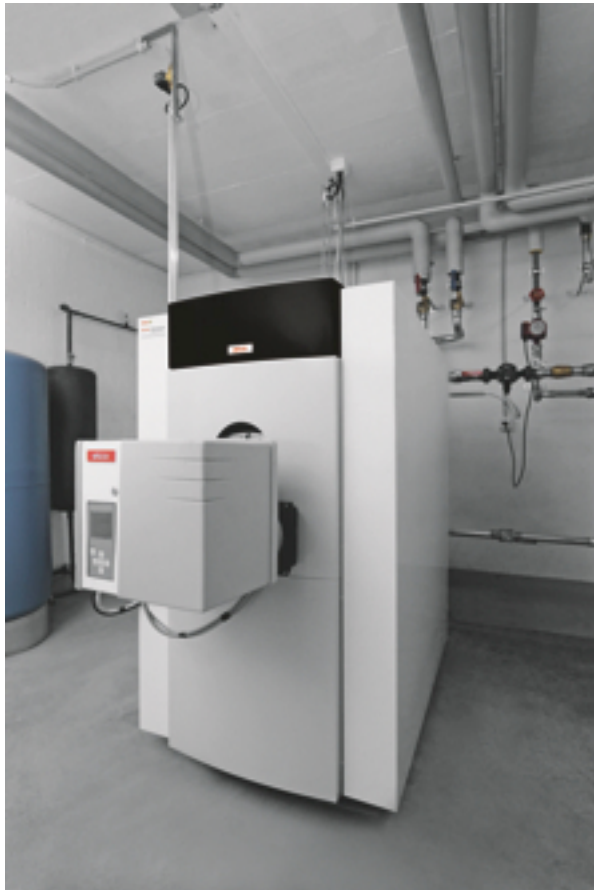
Bild 2: Der STRATON L (im Bild ohne Schallschutzhaube) ist ein Musterbeispiel einer perfektionierten Technik.
