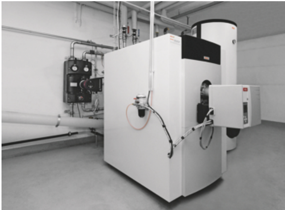
Bild 1: Blick in den Heizungskeller des Mehrfamilienhauses in Freienbach mit dem neuen STRATON L und Beistellboiler VISTRON 500 Liter.
