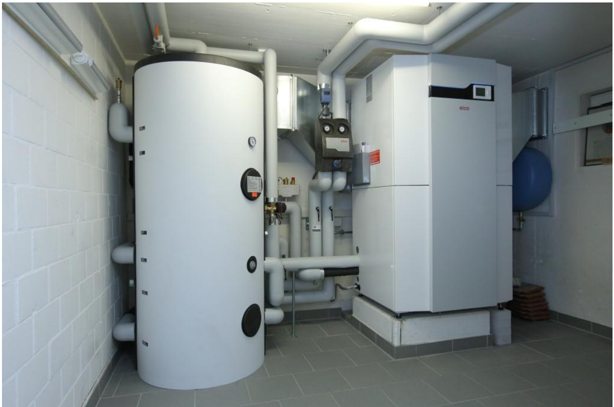
Blick in den Heizungskeller mit Luft-Wasser-Wärmepumpe und Kombispeicher.
