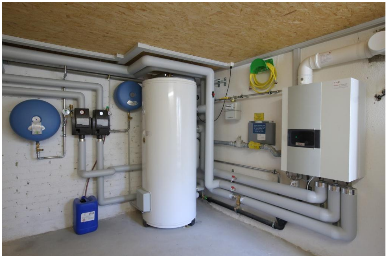
Blick in den Heizungsraum mit Gas-Brennwertkessel, nebenstehendem Warmwassererwärmer sowie Pumpengruppe Solar.
