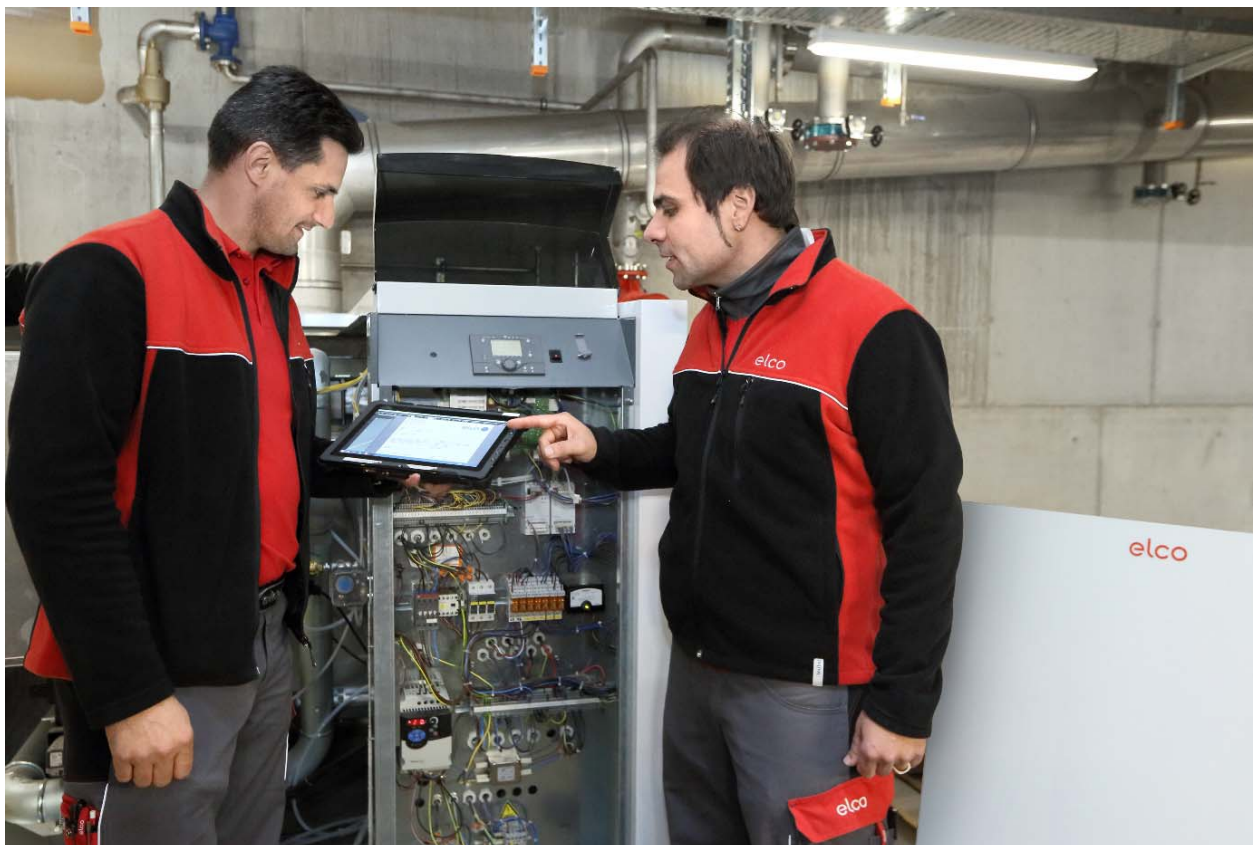
Wartung und Unterhalt der neuen Anlage liegen künftig in den Händen von ELCO Servicetechniker Sabit Suljic (l) und Gruppenleiter Luigi Lavagna.
