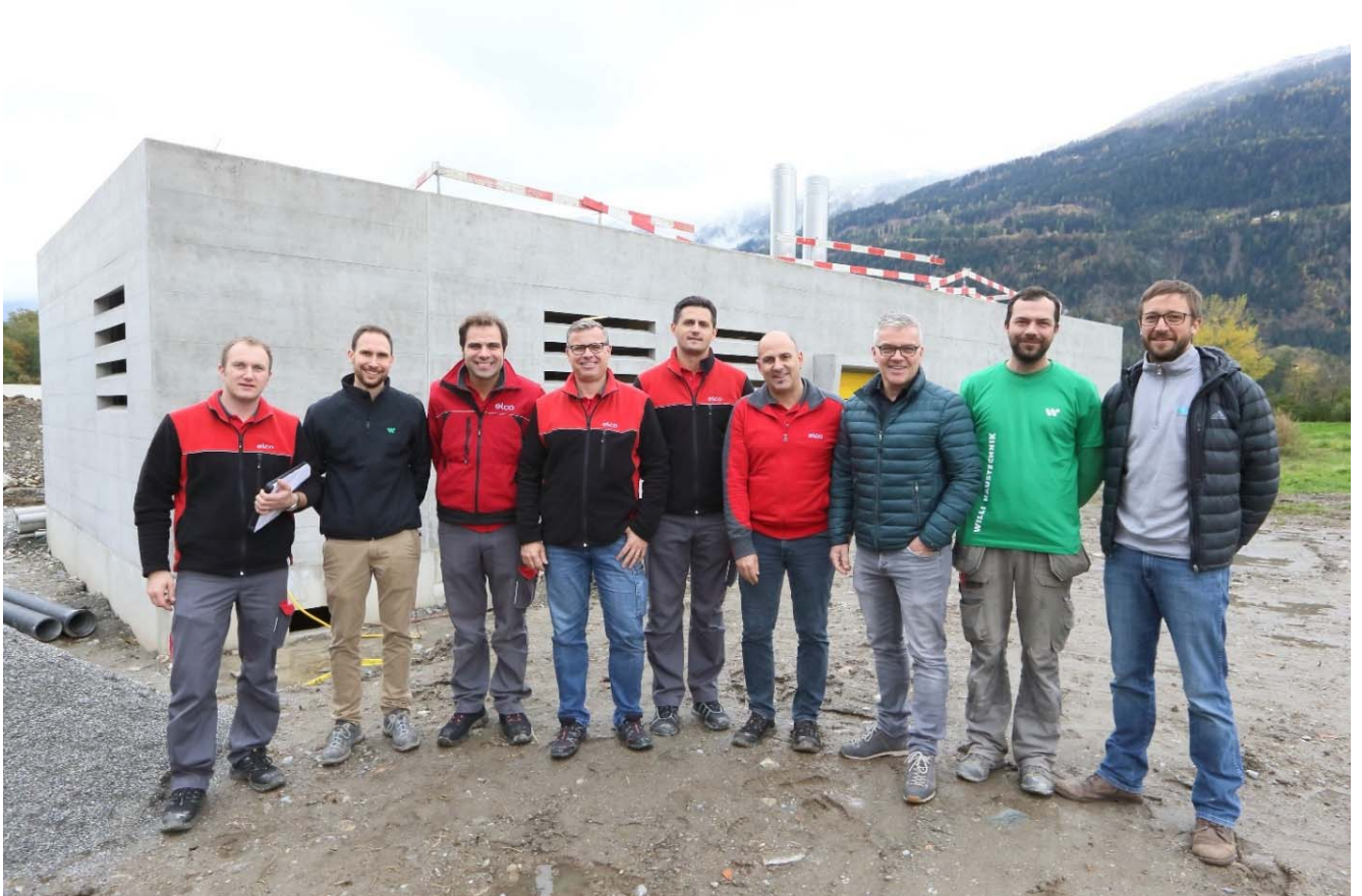
Gruppenbild vor dem Rohbau der Energiezentrale am Schifflibach (v.l.n.r.): Michael Schmid (ELCO), Franco Roffler (Willi Haustechnik), Luigi Lavagna, Marcel Jaberg, Sabit Suljic, Jürg Denger, Kurt Willi (alle ELCO), Semir Hero, Willi Haustechnik, und Florian Eigner, IBC.
