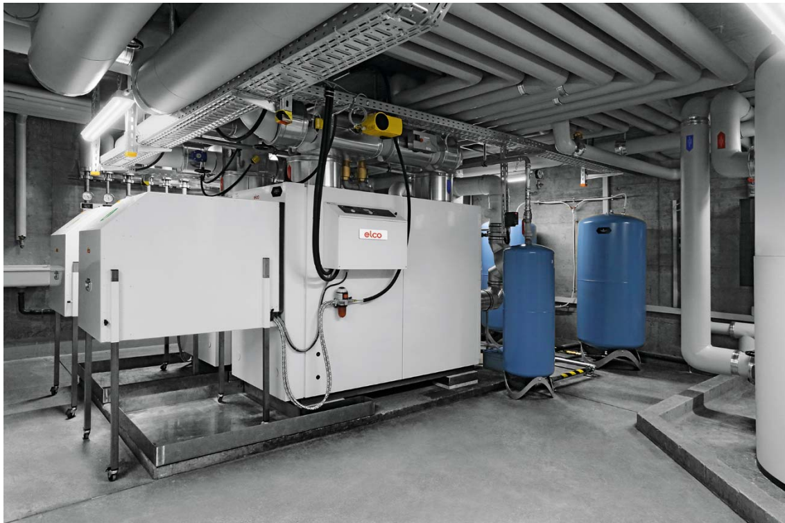
Blick in die Heizzentrale mit den beiden vollkondensierenden Öl-Brennwertkesseln STRATON XL und einem der beiden Pufferspeicher VISTRON B 2'000 Liter.
