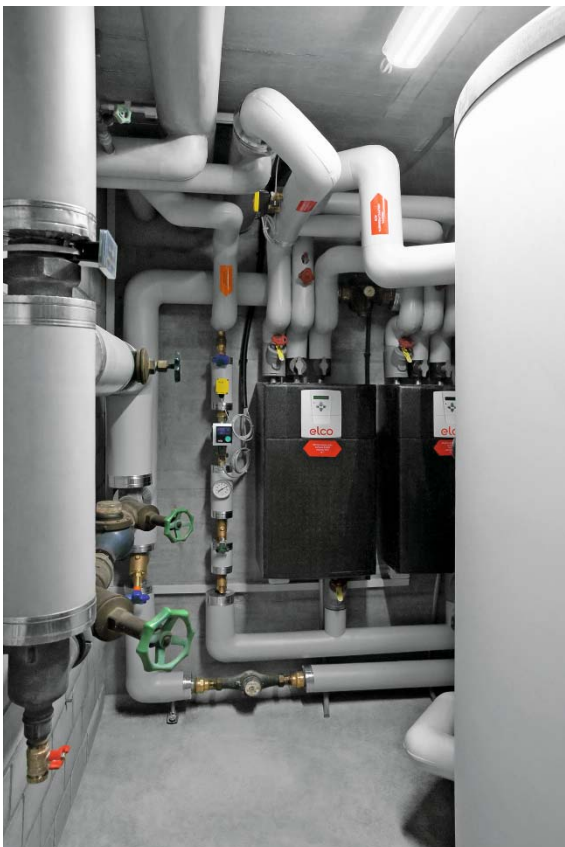
Eine Kaskade mit zwei Frischwasserstationen und ein Pufferspeicher VISTRON B 1'500 Liter sind in der Unterstation untergebracht.
