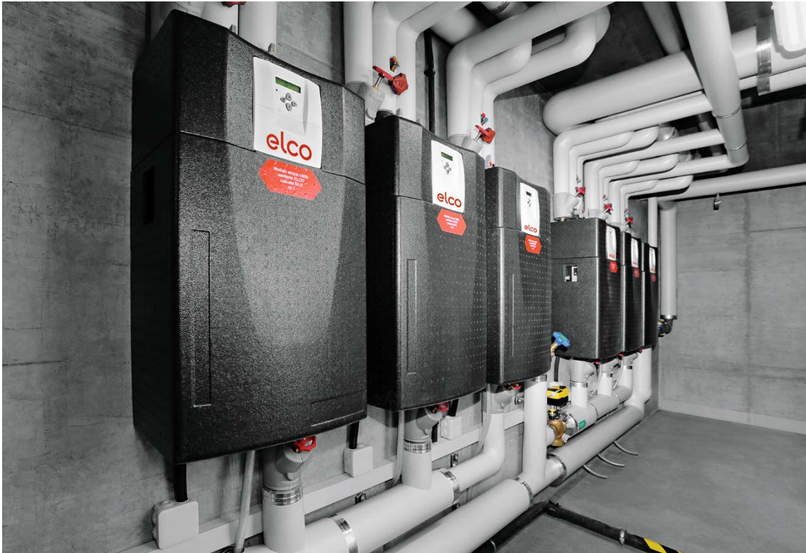
Sechs der acht Frischwasserstationen des Typs 50-2 bzw. zwei Kaskaden zu je drei Einheiten wurden in der Heizzentrale installiert.
