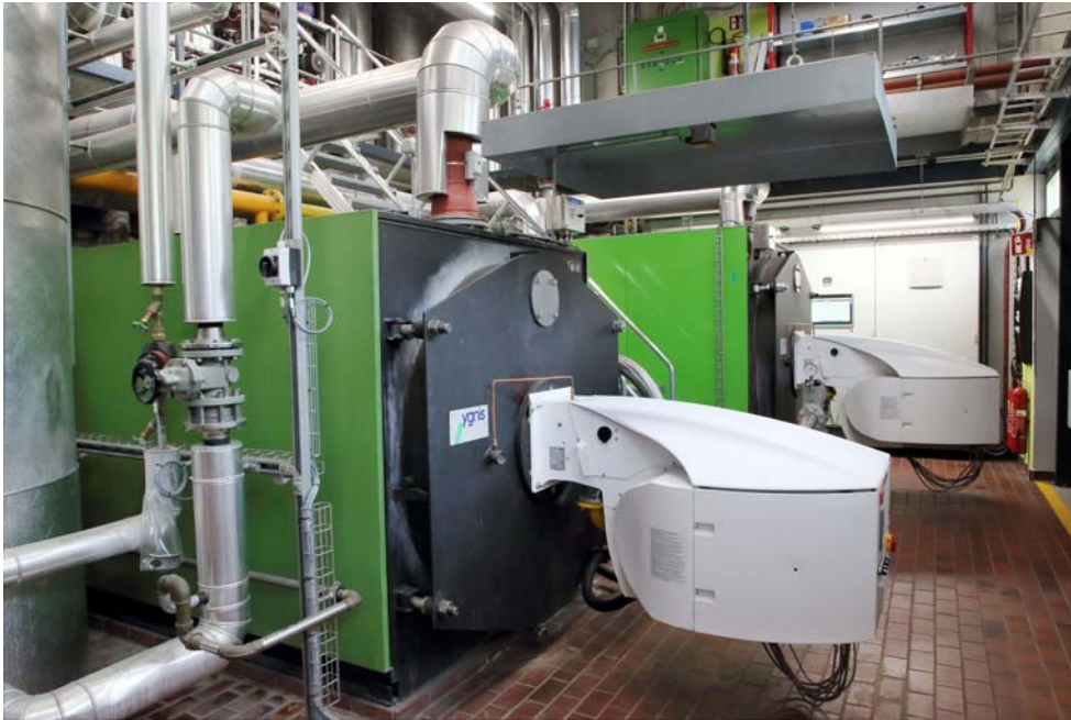
Blick in die Heizzentrale mit YGNIS-Heizkesseln und den neuen Monoblock Gasbrennern NEXTRON.
