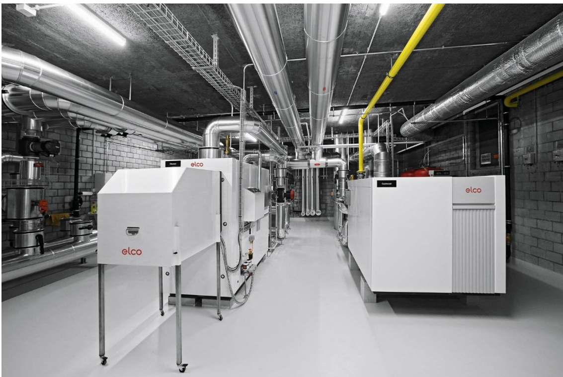
Ein Gas-Brennwertkessel RENDAMAX 3604 (r) und ein Öl-Brennwertkessel STRATON XL gewährleisten eine effiziente Wärmeerzeugung.
