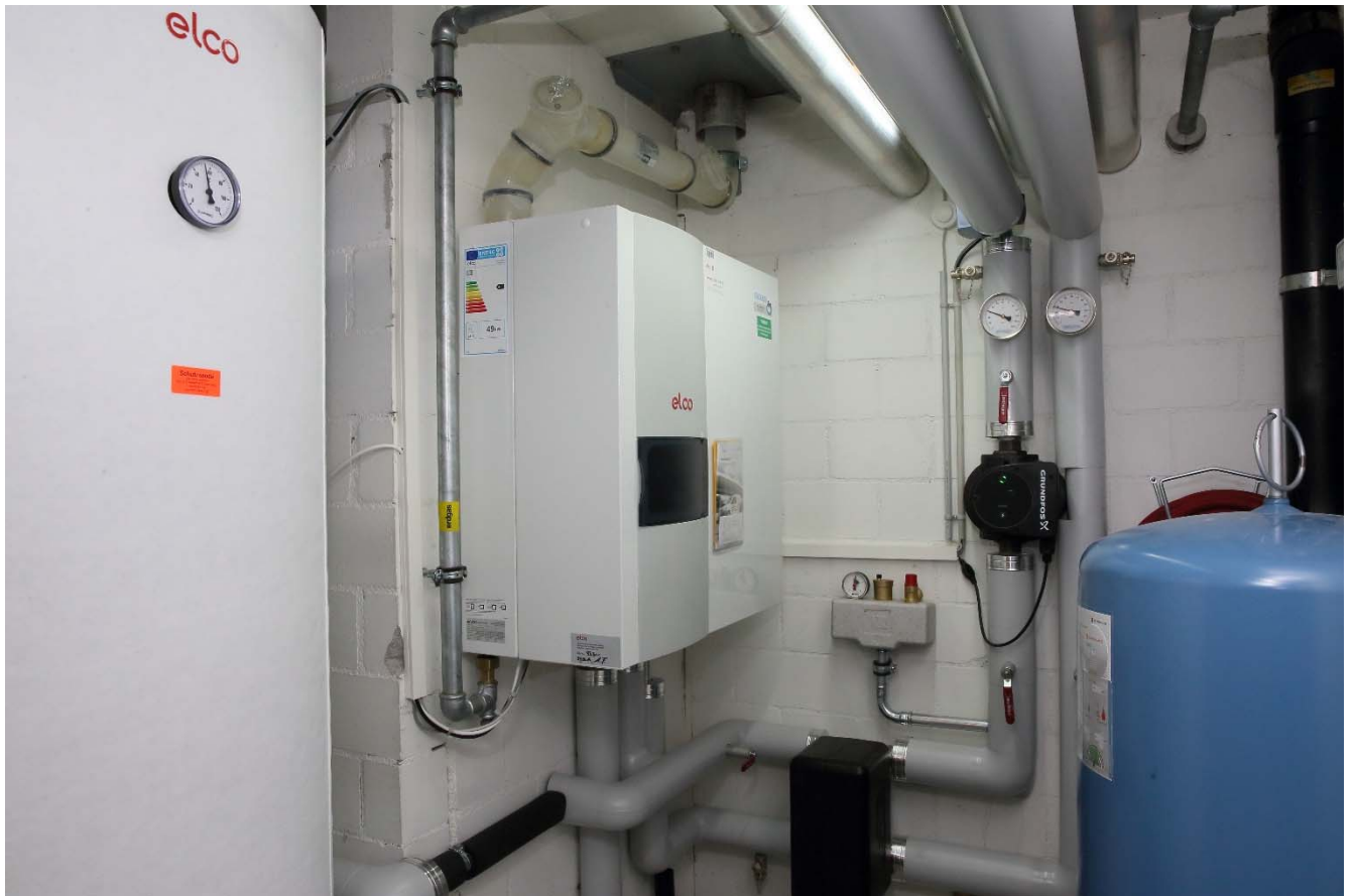
Blick auf die neue Heizungsanlage in einem Mehrfamilienhaus mit dem Wärmeproduzierer THISION S 50.2.
